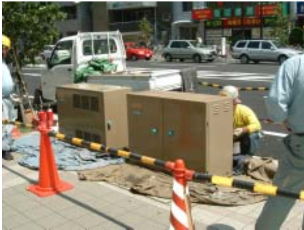
関西電力神戸 トランスボックス試験
